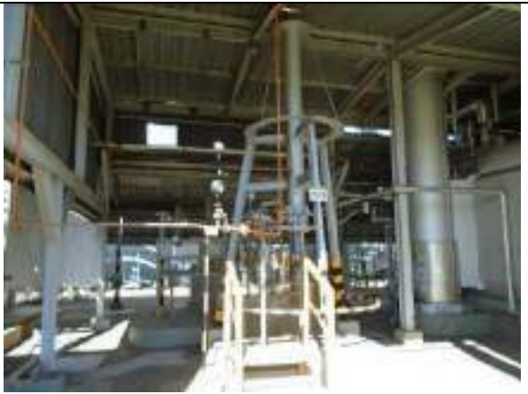
BANCO ALIMENTADOR DE GLP TTU-923A
