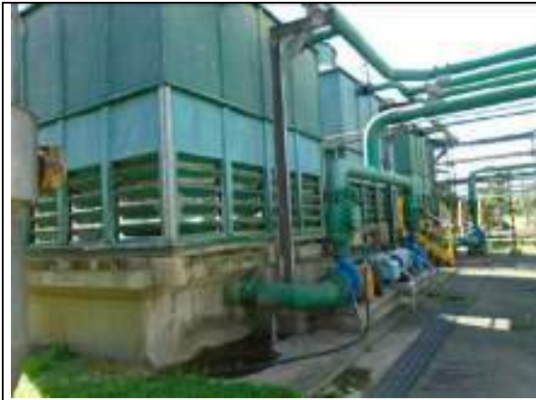
VISTA PARCIAL DAS TORRES DE RESFRIAMENTO
